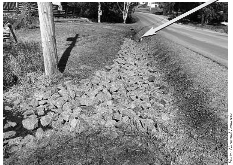
Nouveau déversoir de 46 cm ou 18 po installé à l'automne 2012. Le niveau du lac étant à une hauteur maximale au moment de la photo, on n'y dénote aucune trace d'eau dans le fossé de pierre qui mène au déversoir.
