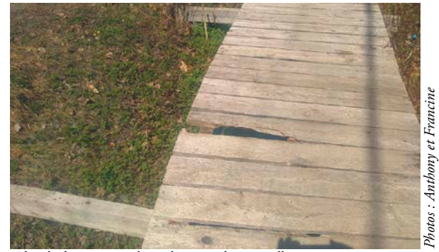
Planche brisée à remplacer dans une des passerelles.
